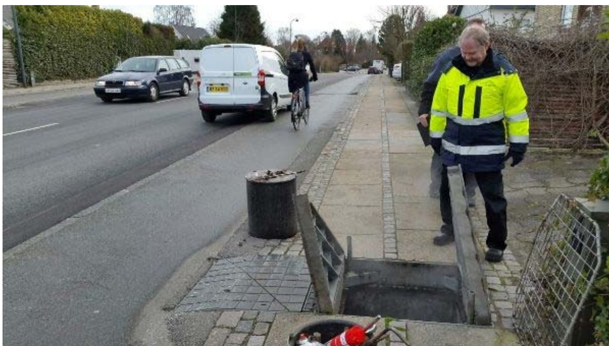
Utæt fjernvarmerør, Hans Jensens Vej i Gentofte
