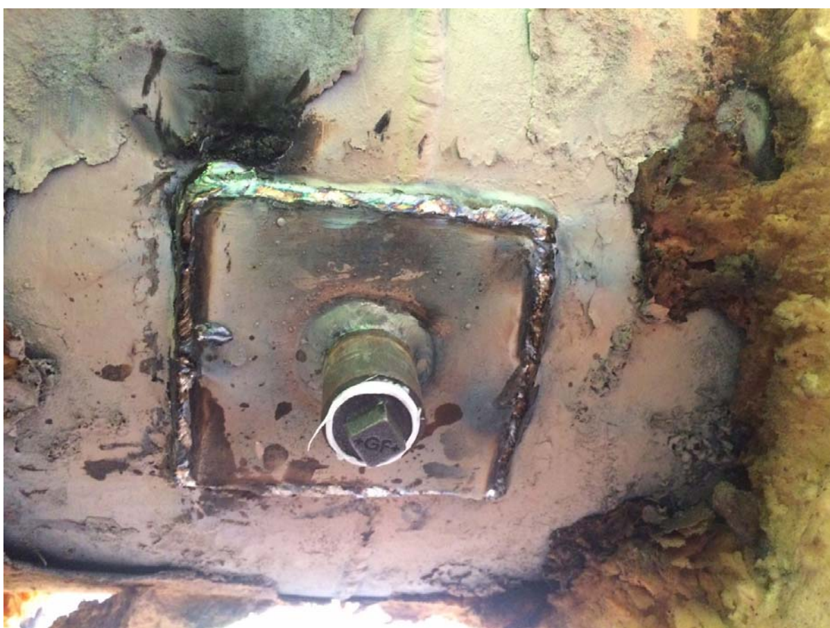
En midlertidig lap er svejset på fjernvarmerøret.
